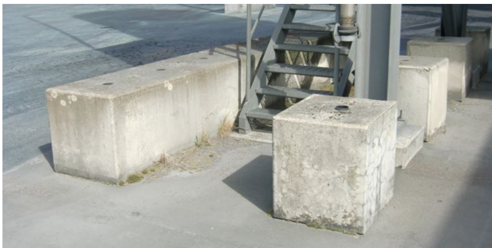
Bild 17 Betongblock som påkörningsskydd. Foto: Björn Haase, Höganäs AB
