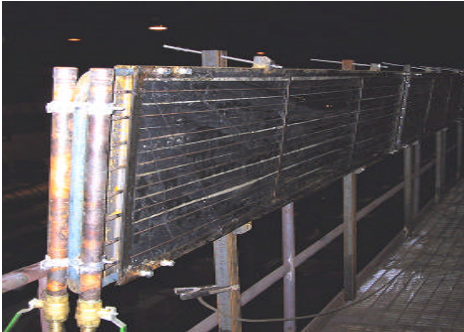
Figur 6. Solvärmepaneler monterade i isolerad låda i OVAKO:s valsverk i Hällefors
